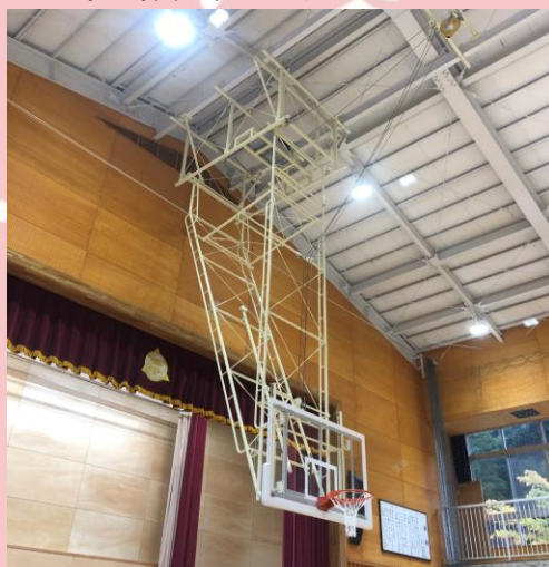
山口県内体育館 ・ 吊下げ式バスケットゴール
